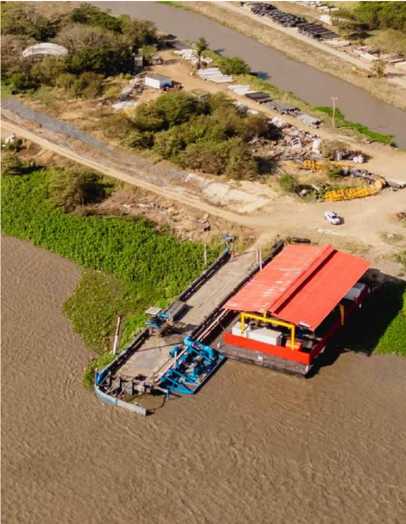
Bombas sumergibles de apoyo para calidad de agua
