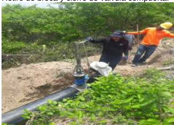
Verificación del funcionamiento de la ventosa.
